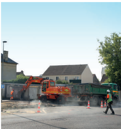
// 30 juillet. Travaux de requalification du carrefour au croisement de la rue Jules Uhry, rue Lesieur et de la Cavée des Aiguillons et d'autre part, de la réfection de chaussée de la rue du général de Gaulle.
